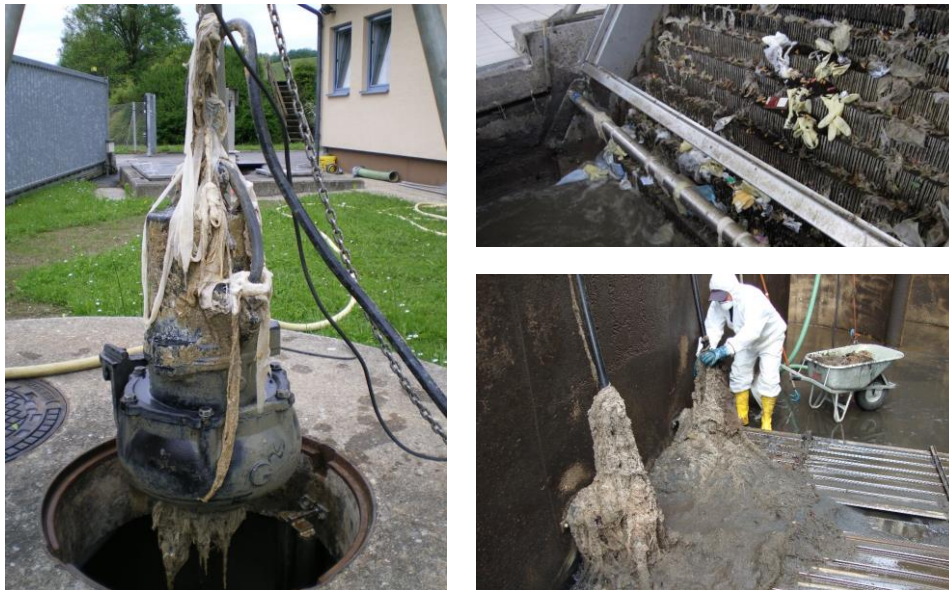
Abbildung 1: Problematik von FT in einer Rechenanlage (rechts oben), bei der Verstopfung von Pumpen (links) und anderen Einrichtungen von Kläranlagen (rechts unten).
