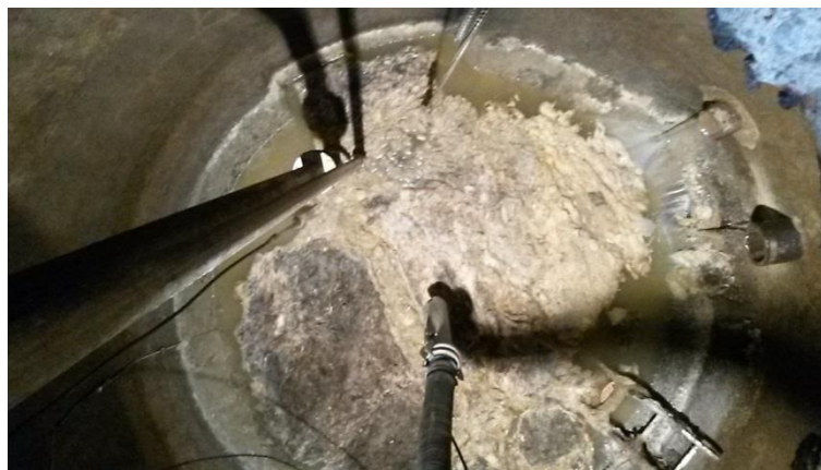
Abbildung 5: Blick von oben auf die Schwimmschicht einer Pumpstation in Müzzzuschlag
