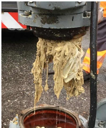
Abbildung 6: Eine zerlegte Pumpe mit Verzapfung aus FT aus einer Pumpstation in Kapfenberg
